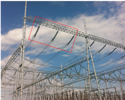
图 1 某 750 kV 变电站末端门型架实物
